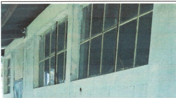
Foto 3: se observa en la fotografía el deterioro del vidrio de las ventanas de la Escuela.
