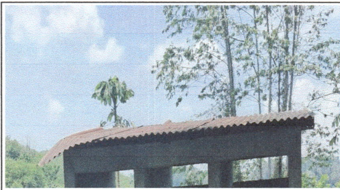
Foto 4: se observa en la fotografía el deterioro del techo del baño de la Escuela.
