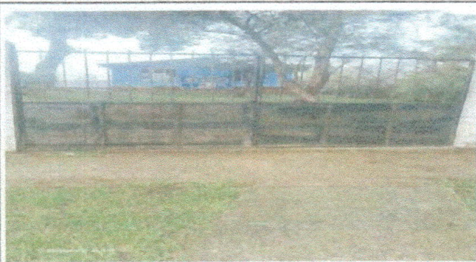
Foto 9: Se observa en la fotografía el deterioro del porton de la escuela.
