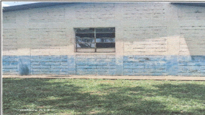
Foto 2: se observa en la fotografía el deterioro de la pintura de la pared interior y exterior.
