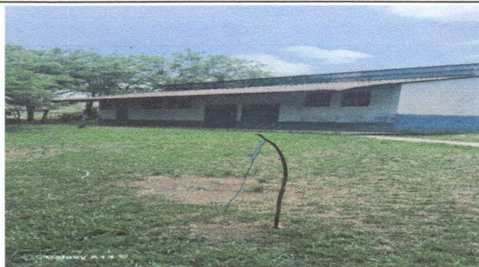
Foto 1: Se observa en la fotografía el deterioro del techo de la escuela.
